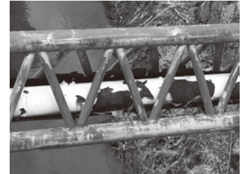
外被が剥がれてきた水道管
